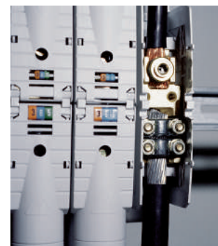
Közvetlen csatlakozás Al/Cu
